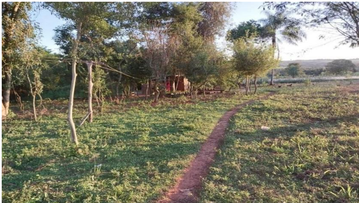
Fuente: Camino interno comunidad con vista de la precaria instalación eléctrica entre una vivienda y otra, 11.05.23
